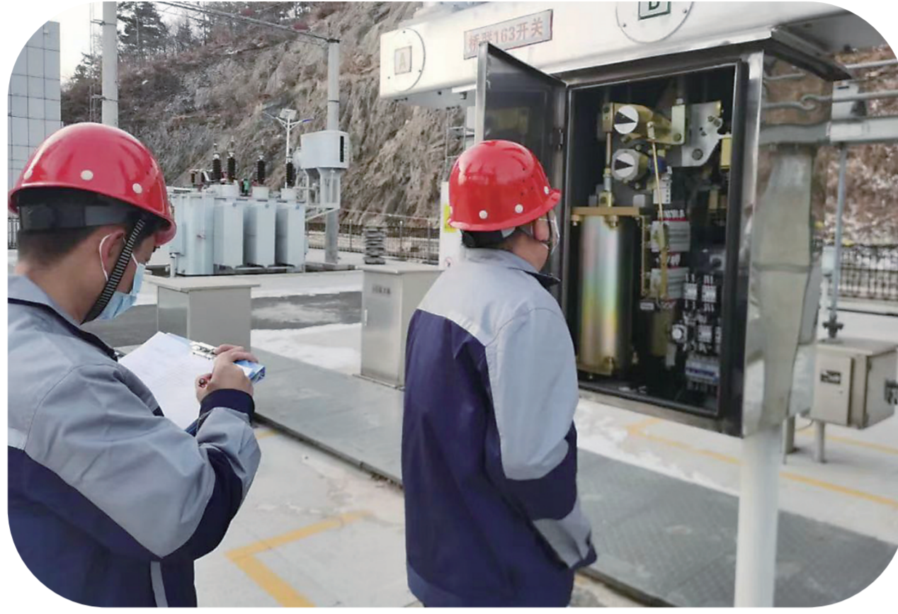
新城泵站巡检人员依次在变电所机组设备前按照“听摸察看闻”五步工作法实操应答。
